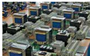
Цех складання електрообладнання
